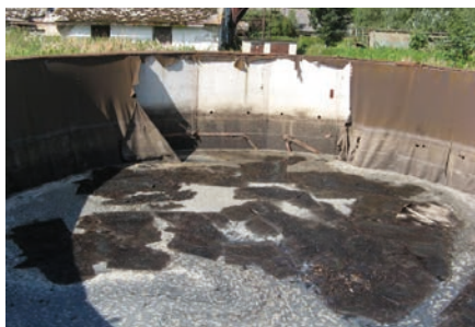
Nevhodné skladování závadných látek, zdroj: ÚKZÚZ
