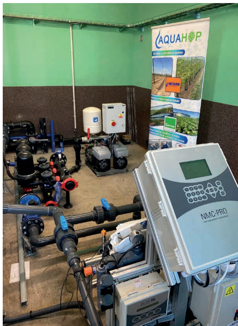
Filtration station with Fertikit Filtrační stanice s Fertikitem
