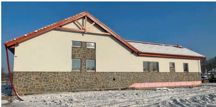
Hluboká nad Vltavou – čistírna odpadních vod – město – spolufinancováno z dotačních prostředků MZe ve výši 50,000 mil. Kč
