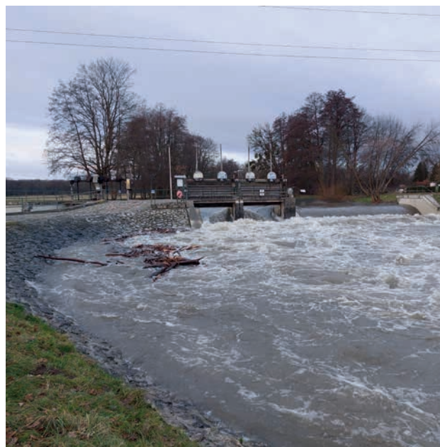
Morava – jez Litovel, povodeň prosinec 2023 (zdroj: Povodí Moravy)
