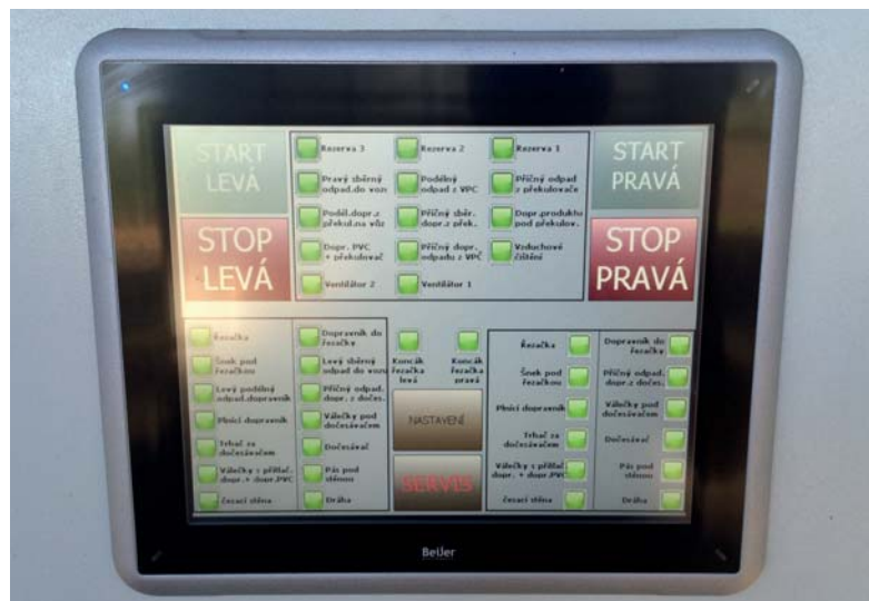
Touch screen of the control panel Dotykový display ovládacího panelu
