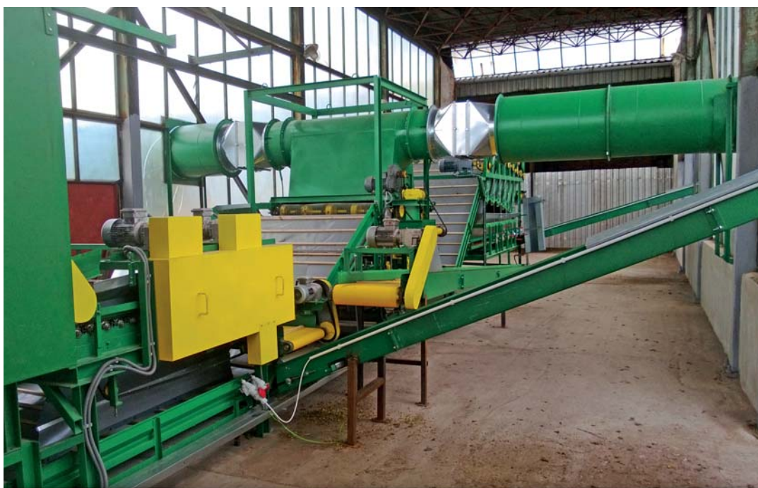
PT-2 000 separation line (Stekník) Separační linka PT-2 000 (Stekník)
